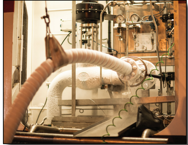
3" LNG Bunker Line
